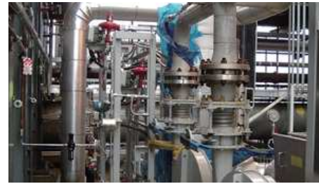
Dilution Air Fan
